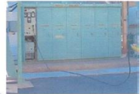
Ο χειρισμός διακόπτη από απόσταση. Είναι ένας πολύ καλός τρόπος προστασίας
